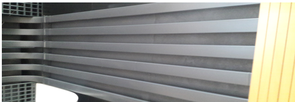
شبکه داخلی سیستم پنوماتیک برای انتقال مدارک در تالار خدمات عمومی
